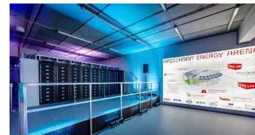
スタジアム内部の大型蓄電池
