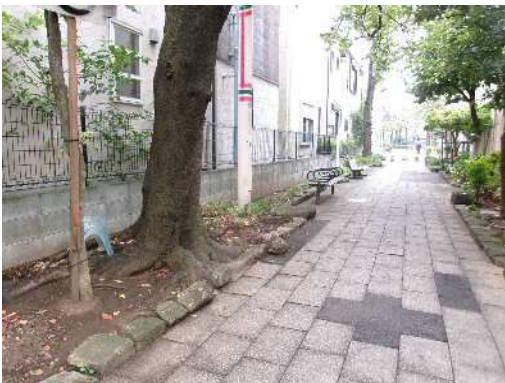
樹木の根上がりで縁石が凸凹になった歩道
