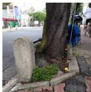
樹木の根上がりや凸凹になった歩道の舗装
