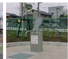
防災井戸・手押しポンプ
