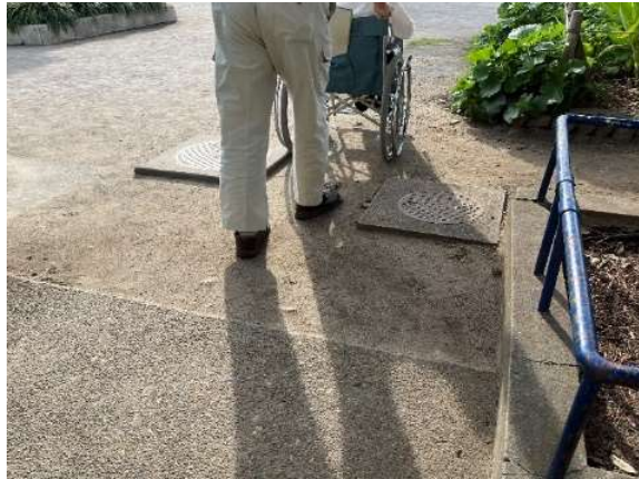
公園内の園路の段差
