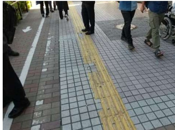
駅前広場における一部が剥がれた 視覚障害者誘導用ブロック
