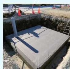
プラスチック貯留槽
