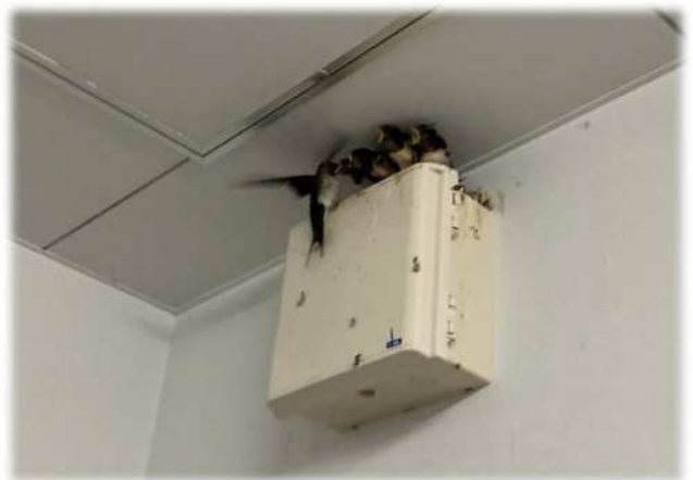
写真② 東金町1丁目 駐輪施設内の巣
