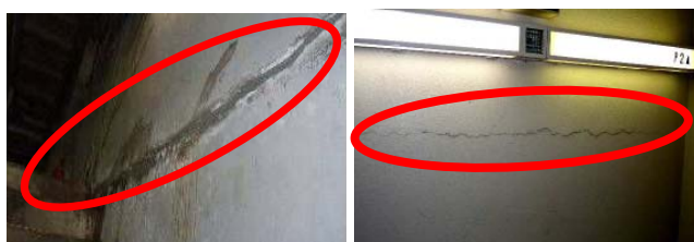
壁のクラック（ひび割れ）が目立つ
