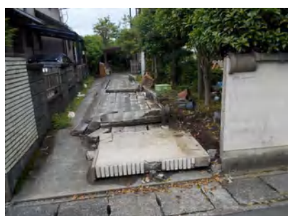
倒壊したブロック塀
