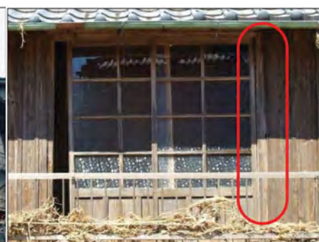
建具：損傷程度25%
