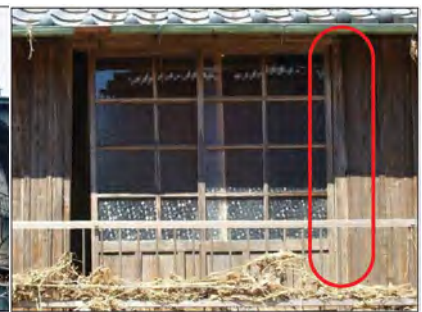
建具：損傷程度25%
