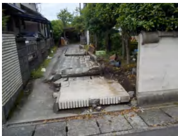
倒壊したブロック塀
