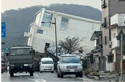
倒壊したRC造↓
